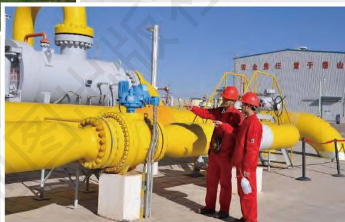
西气东输管道安徽境内的太和分输站
